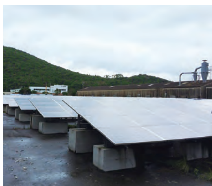
◆ 太陽光発電設備
